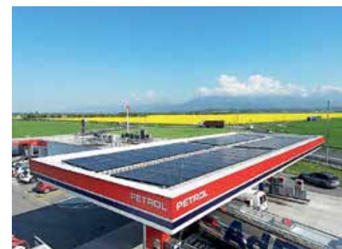
Sončna elektrarna na prodajnom mestu
